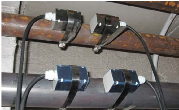
Eingriffsfrei am Rohr
