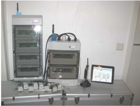
Entwickelte Messstation Ultraschallmehrkannalmessanlage Online 32 Heizkreise
