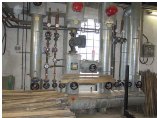
Lastmessungen in Trockenkammern von Sägewerken für Holz BHKW Dimensionierung
