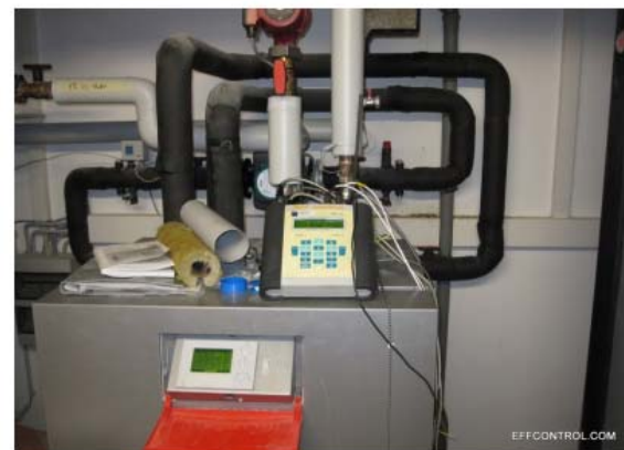
Überprüfungen von Wärmepumpen und Solaranlagen
