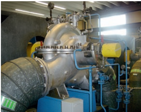
Fernwärme Ulm: Umwälzpumpe des Fernwärmenetzes für das Industriegebiet Ulm-Donautal.
