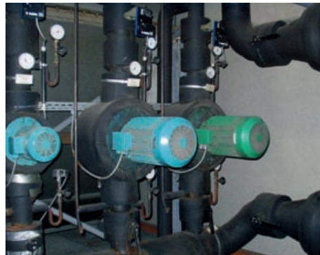
Reuther Verpackung GmbH & Co. KG: Pumpen des Kaltwassersystems für die thermische Nachverbrennung.
